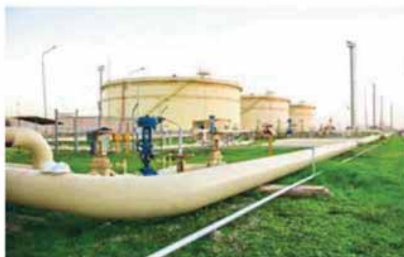
شکل ۲۰- نمایی از خطوط انتقال سوخت
