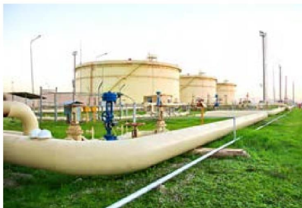
شکل ۲۰- نمایی از خطوط انتقال سوخت
